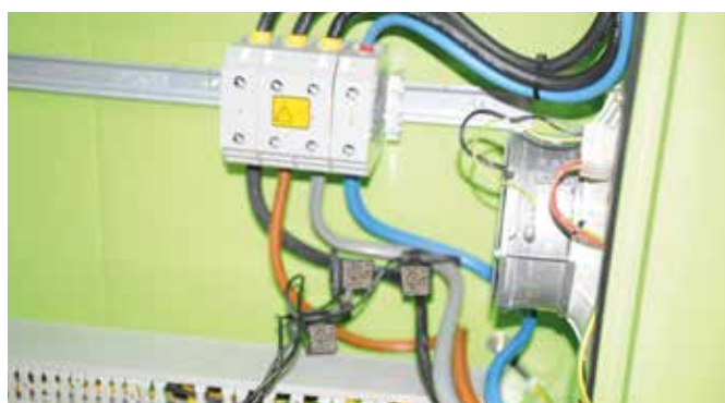
Schnelles Anlegen der Rogowski-Spulensätze durch Klippverfahren an Maschinezuleitung
